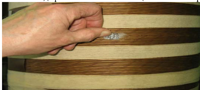
Рис. 3. Вид дефекта витковой изоляции обмотки силового трансформатора.
