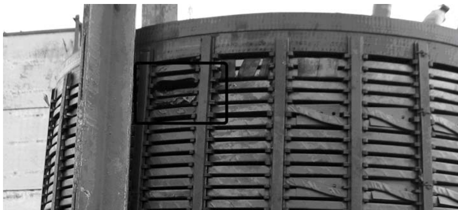
Рис. 1. Дефект обмотки трансформатора ТДТН-63000/110
