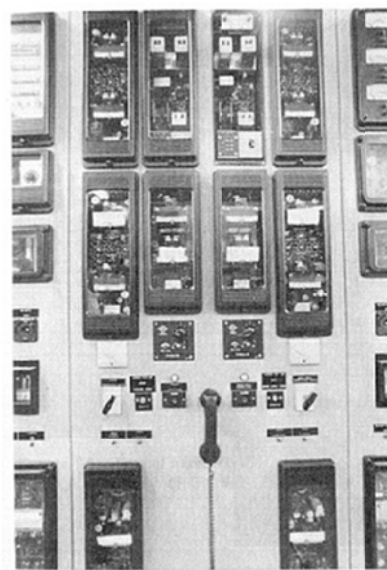
Рис. 2. Типовая панель защиты линии, выполненная на электромеханических реле
