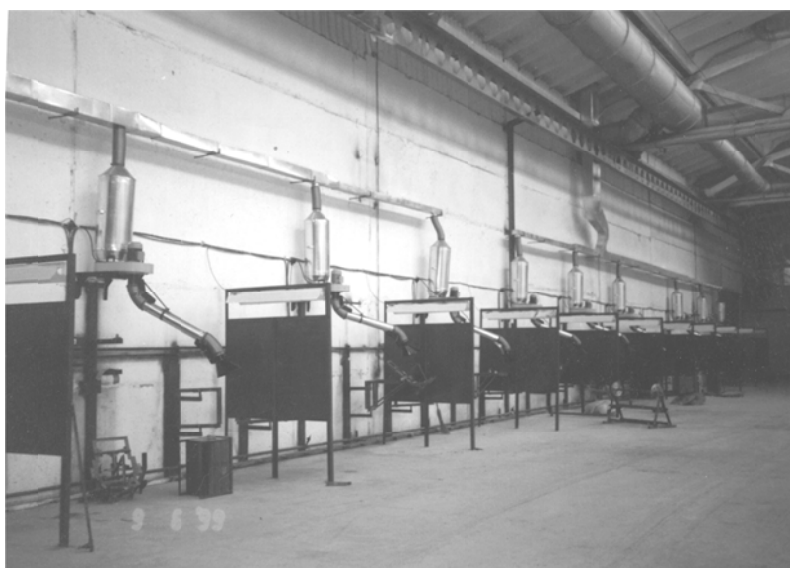
Рис. 5.7. Стационарная настенная фильтровентиляционная система на основе ФВА «Темп-2000» с нижним расположением воздуховодов
