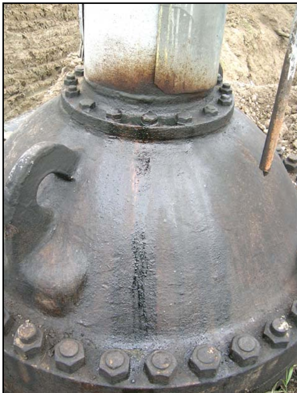
Рис. 5.14. Утечки нефти выявляют визуальным осмотром
