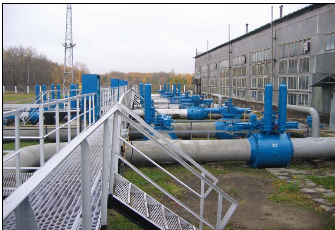
Рис. 1.4. Технологические трубопроводы КС
