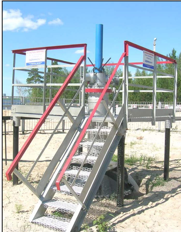
Рис. 5.13. Площадка обслуживания запорной арматуры
