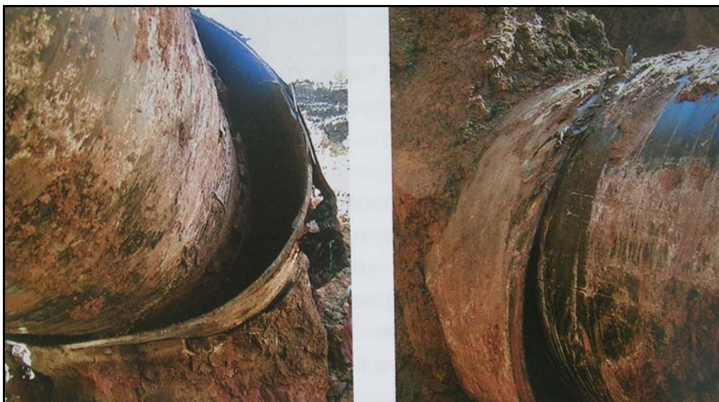
Рис. 5.18. Деформация и смещение защитного кожуха газопровода «Уренгой – Новопсков» под железной дорогой Пермь – Екатеринбург
