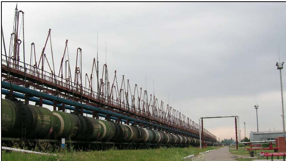
Рис. 1.17. Пункт налива нефти в железнодорожные цистерны
