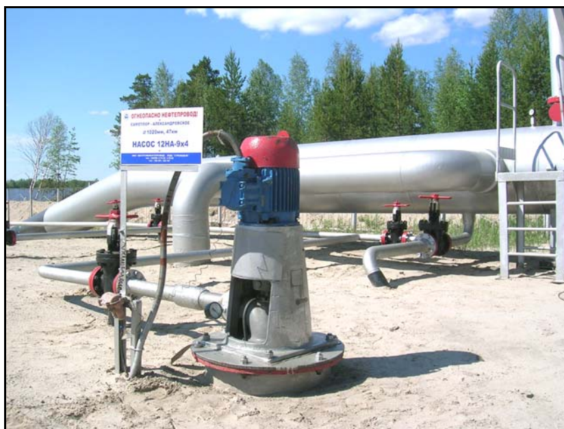
Рис. 5.17. Насос 12НА-9х4 для откачки дренажной нефти
