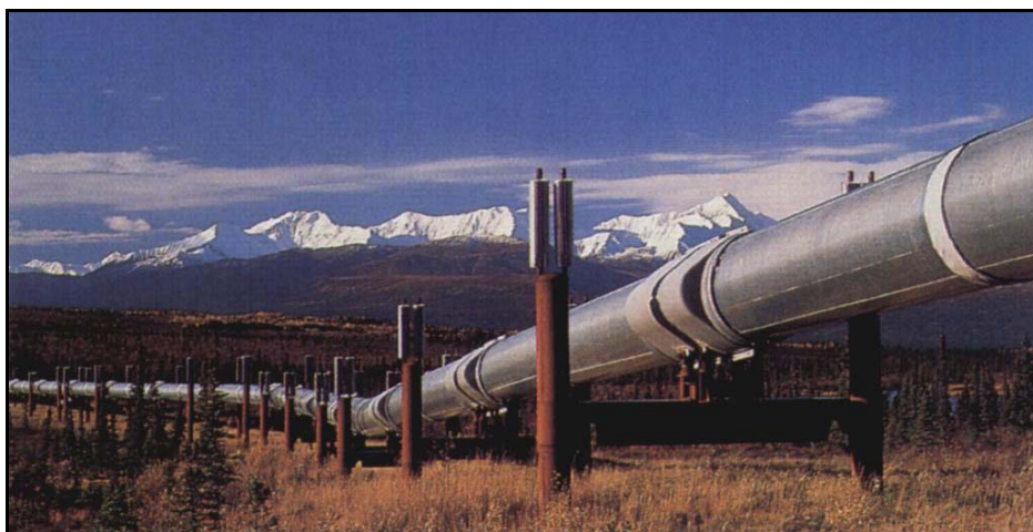
Рис. 1.3. Надземный магистральный трубопровод
