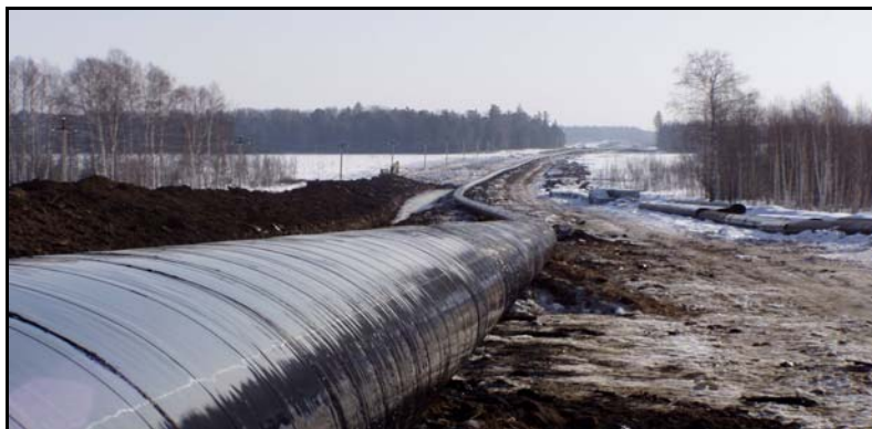
Рис. 1.13. Трубопровод – сваренные в непрерывную нитку трубы
