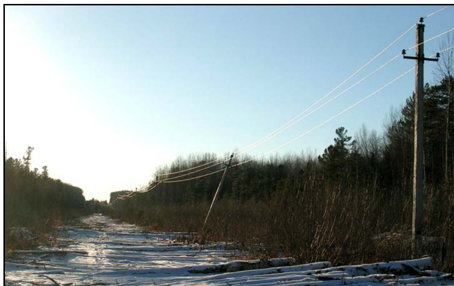
Рис. 5.21. Неисправность опоры линии электропередачи
