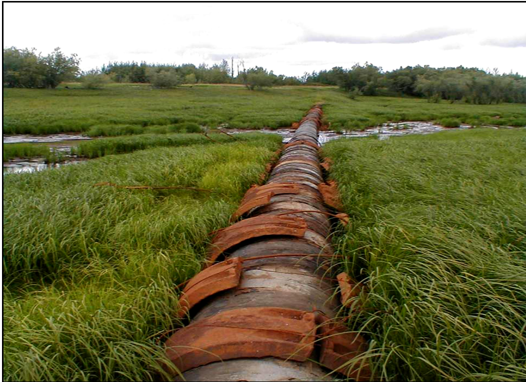
Рис. 2.2. Всплывший участок магистрального газопровода
