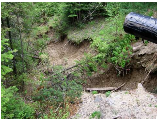
Рис. Эрозия, созданная потоком воды из водопропускной трубы
