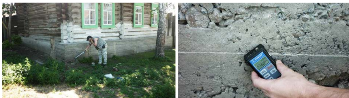
Рис. 5. Обследование фундамента жилого дома (слева); “И вот результат – 0,52 мкЗв/ч на поверхности фундамента” (справа)
