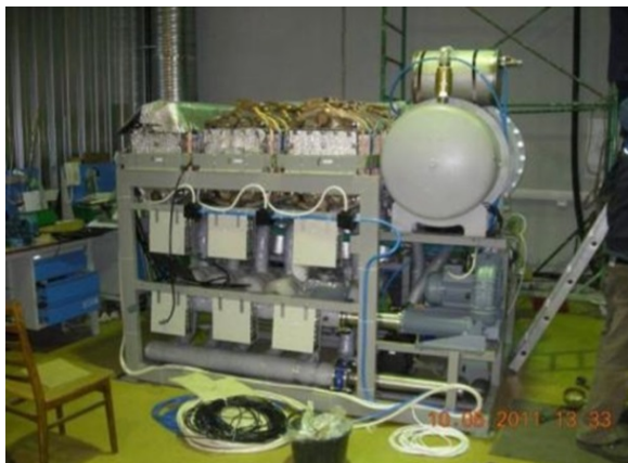
Судовая гибридная ЭУ на основе батарей БТЭ-84 мощностью 60 кВт с конвертером дизельного топлива и утилизацией тепла выхлопных газов в турбогенераторе (2011 год)
