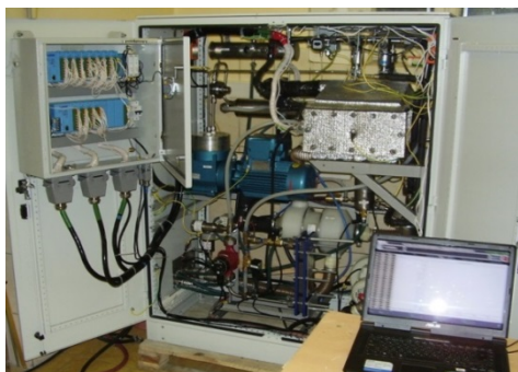
Резервная (аварийная) энергоустановка на топливных элементах РЭУ-5 на основе БТЭ-84 (2009 год)
