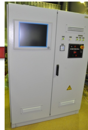
Блок автоматки преобразования и контроля
