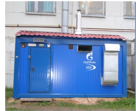
Энергоустановка в контейнере
