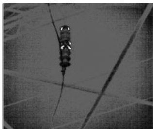
Рис. 3. Гирлянда 110 кВ с дефектными изоляторами
