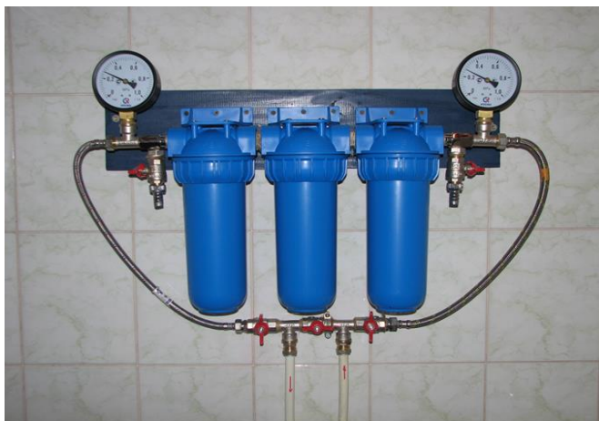
Рисунок 1. Общий вид водоочистной установки
