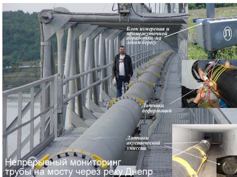
Рис. 96. Непрерывный мониторинг трубы аммиакопровода на мосту через реку Днепр
