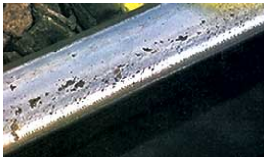
Рис. 1.1. Общий вид головки рельса с трещинами, направленными под углом к оси рельса
