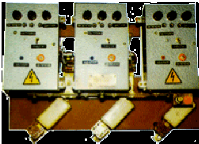
Рис. 3.19. Внешний вид тиристорного коммутатора серии ТК
