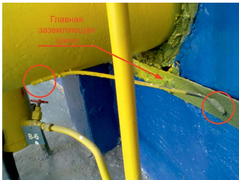
Рис. 2. Контакт газопровода ГРС-4 с контуром заземления сети электроснабжения
