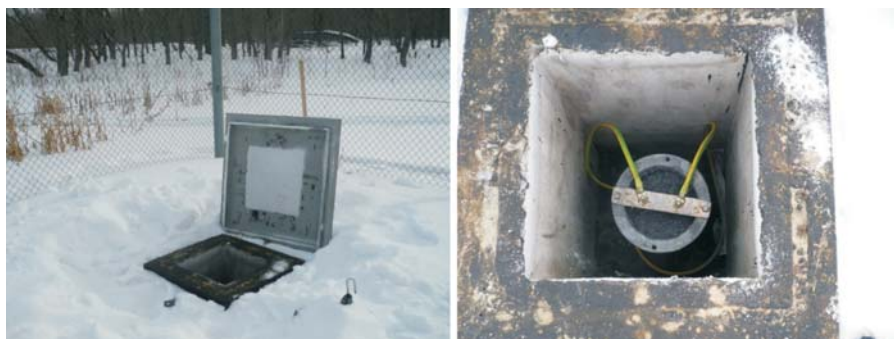
Рис. 2. Скважина с трубчатым заземлителем
