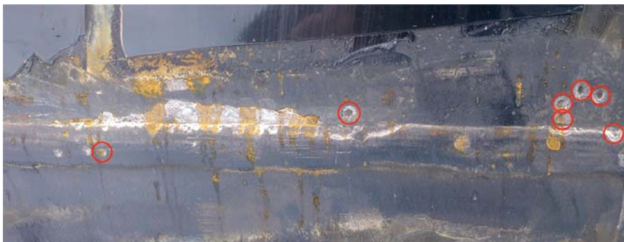
Рис. 2. Поверхность трубы, подверженной коррозии
