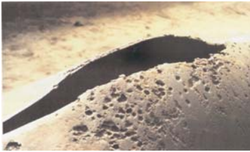
Рис. 1. Аварийное разрушение трубопровода по причине электрохимической коррозии
