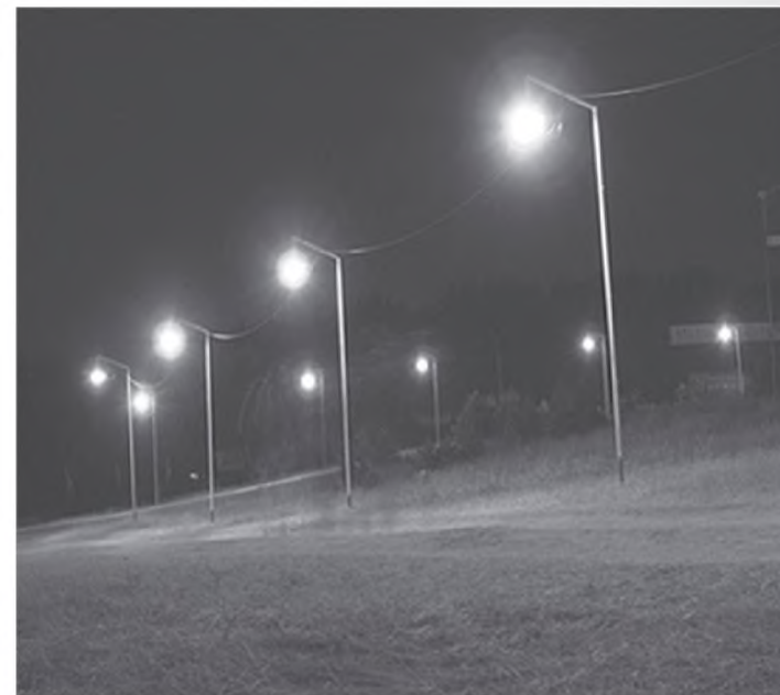
Однопроводная линия освещения (Федеральный научный агроинженерный центр ВИМ)
