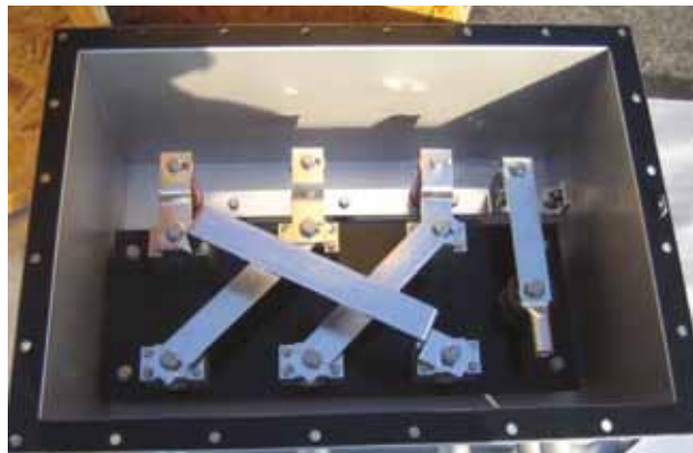
Рис. 2.2 – Пример общего вида шкафа транспозиции экранов
