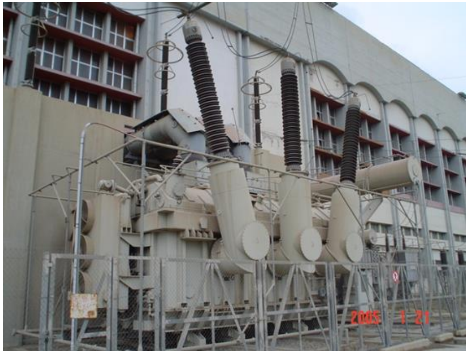
Блочный трансформатор на электростанции
