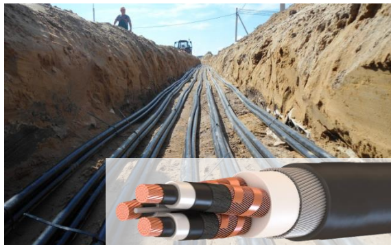
5. Кабельные линии от 6 до 500 кВ
