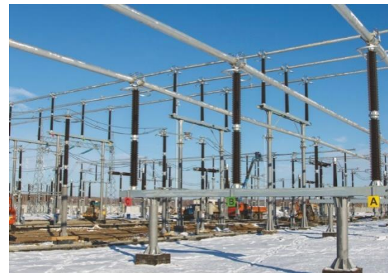
3. Шины распределительного устройства
