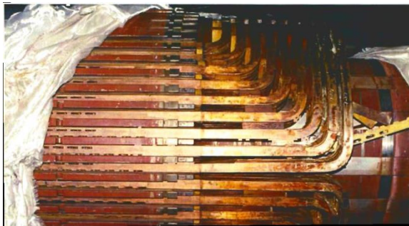
Неповрежденные лобовые части обмотки ротора
