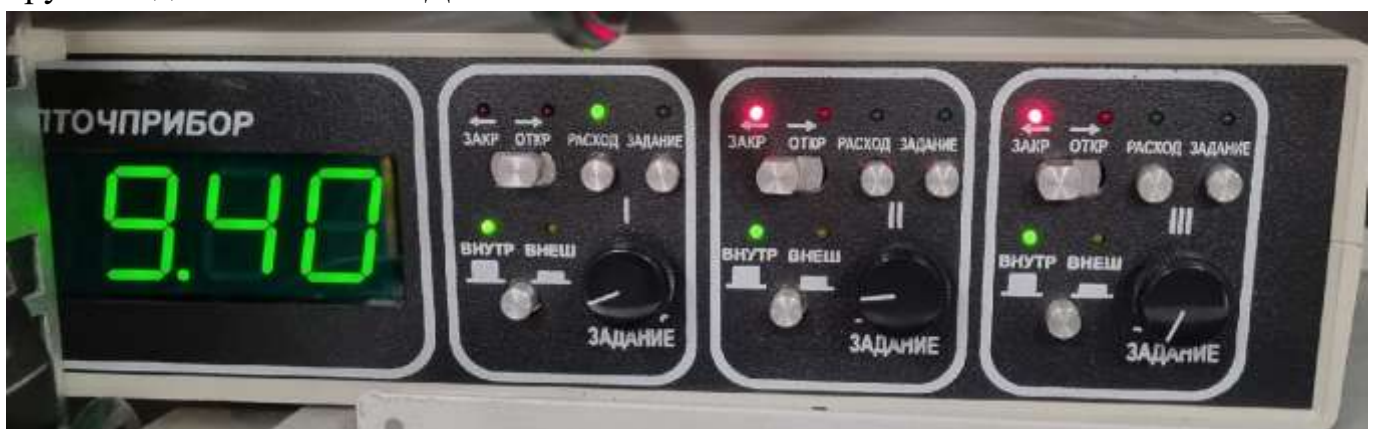
Рисунок 1.11 – Панель управления регуляторами расхода газов.
