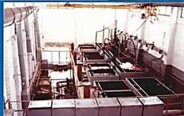
•Станция нейтрализации сточных вод
