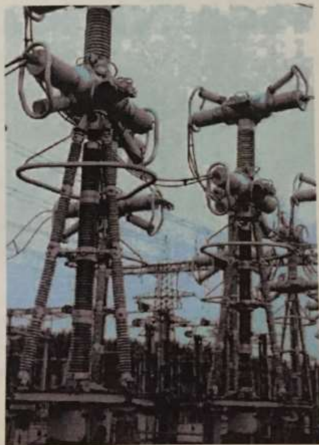
Рис. 2.3. Общий вид воздушных выключателей
