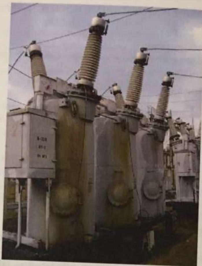
Рис. 2.1. Общий вид баковых масляных выключателей
