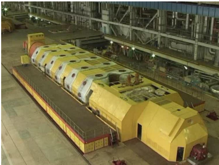
Блок 800 МВт Общий вес вращающихся роторов блока турбина- генератор – сотни тонн
