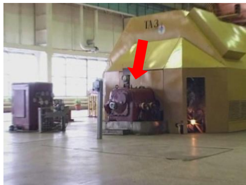
МУТ блока 800 МВт
