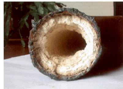
Накипь в трубах теплоснабжения
