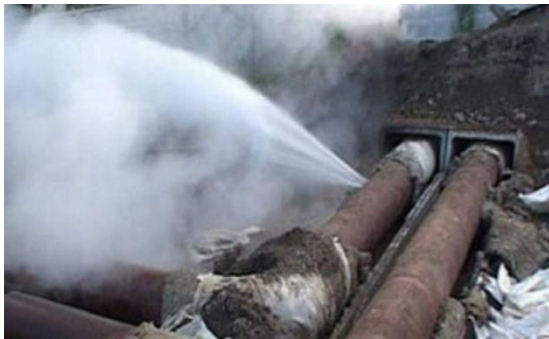
Свист на трубопроводе
