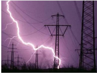
Короткое замыкание на воздушной линии
