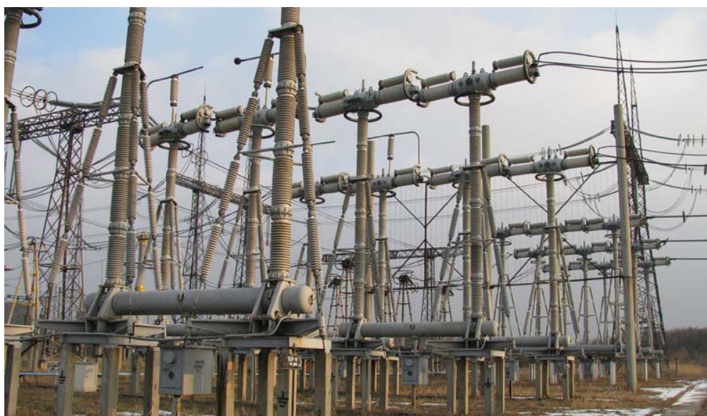
Рис. 4.5. Воздушные выключатели 750 кВ
