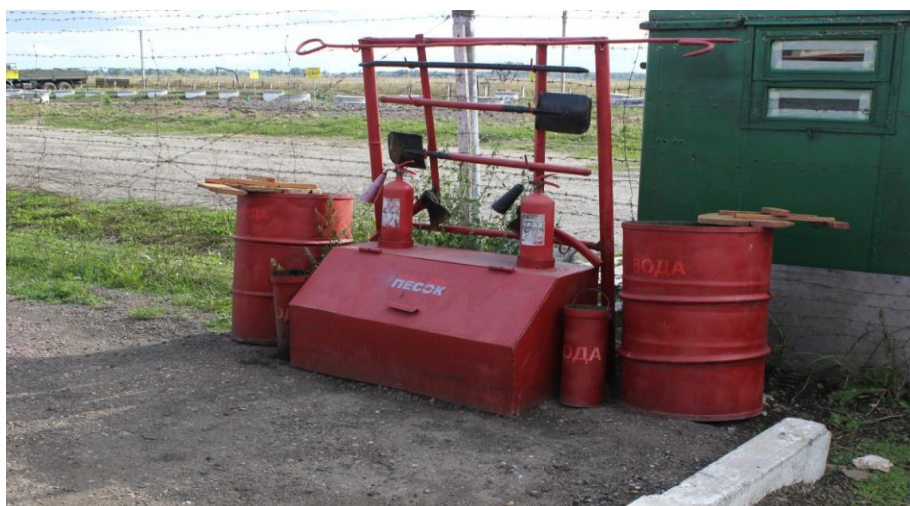
Рис. 8.1. Противопожарный щит в складской зоне СВФ
