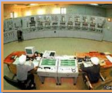
Центр управления АЭС
