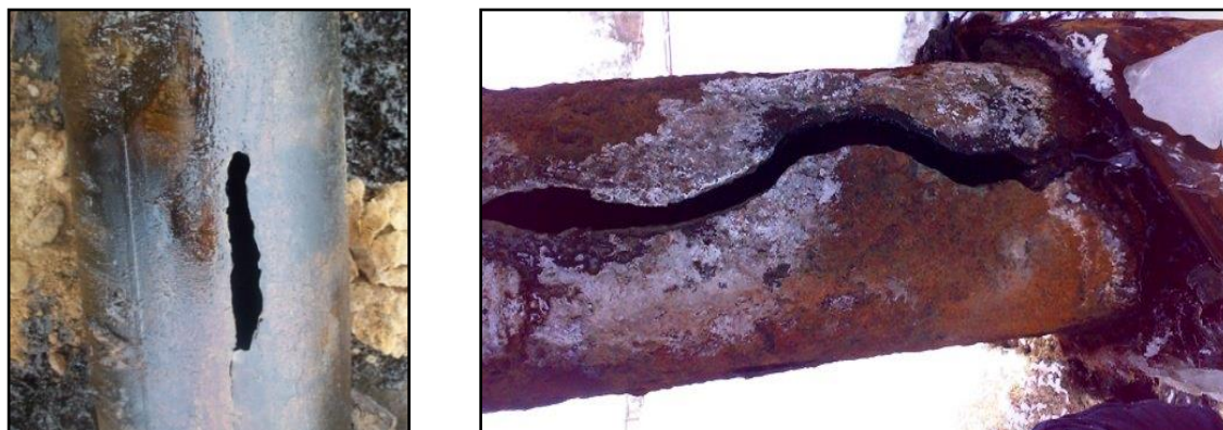
Рис. 4.1. Коррозия нефтесборного промышленного трубопровода
