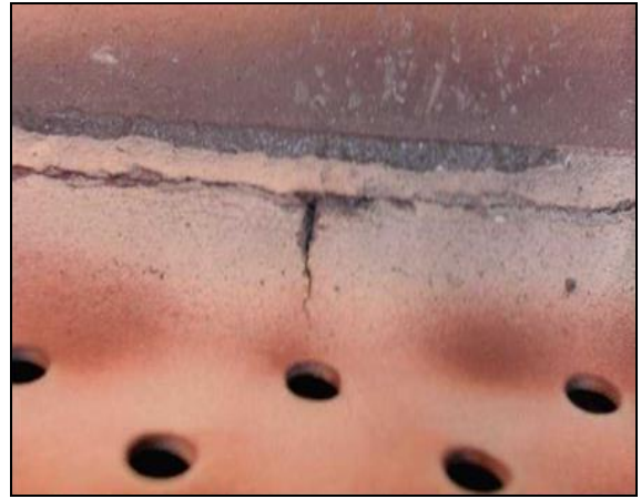
Рис. 1.78. Трещины в околошовной зоне сварного стыка крышки жаровой трубы
