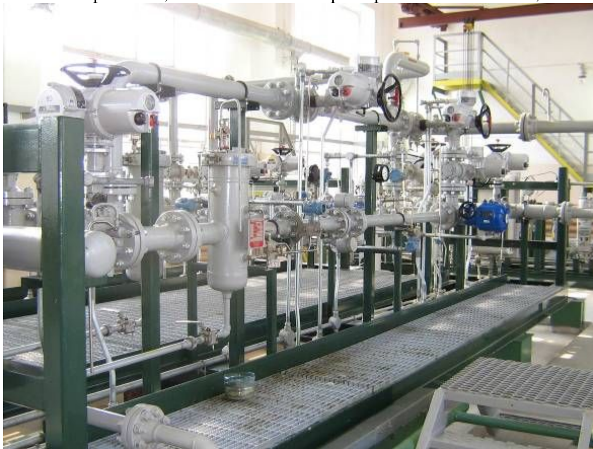
Рис. 4.15. Общий вид блока измерительных линий (производитель FMC «Energy Systems», США)
