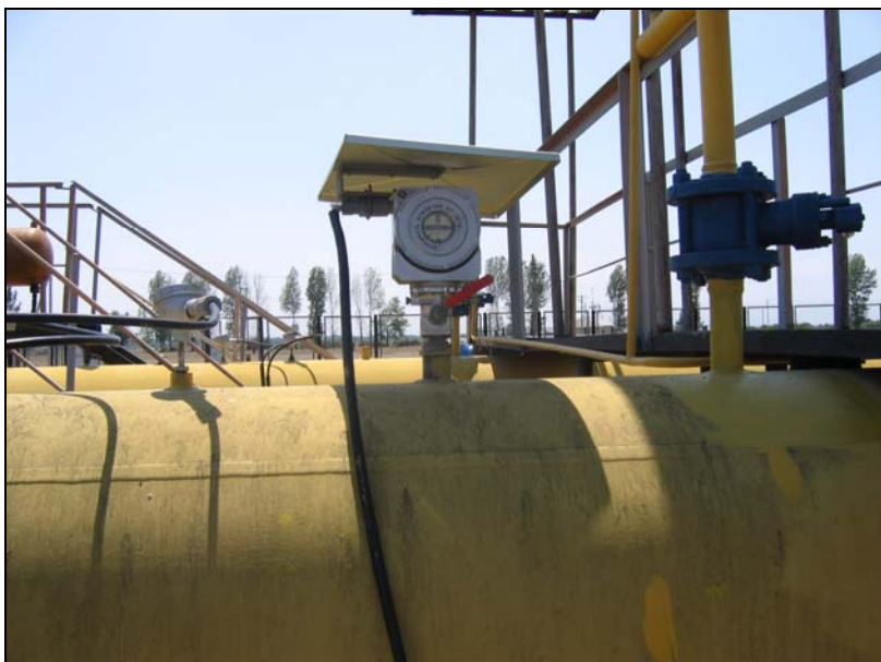
Рис. 4.36. Анализатор точки росы Конг–Прима 2, установленный непосредственно на газопроводе
