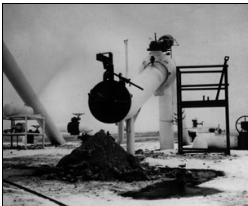
Рис. 4.32. Образование гидратов в газопроводе
