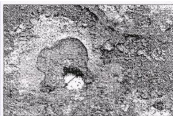
Рис. 6.15. На днище резервуара образовались сквозные отверстия в результате подповерхностной коррозии
