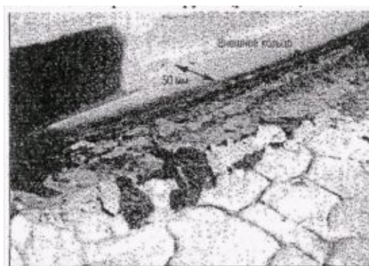
Рис. 6.13. Проявления подповерхностной коррозии
