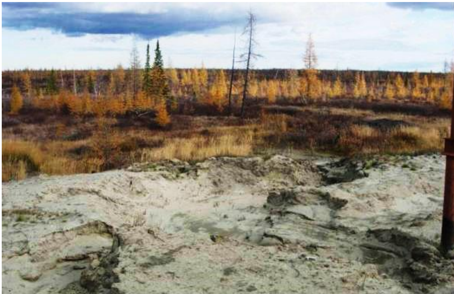
Откос насыпи, подверженный активной водной эрозии
