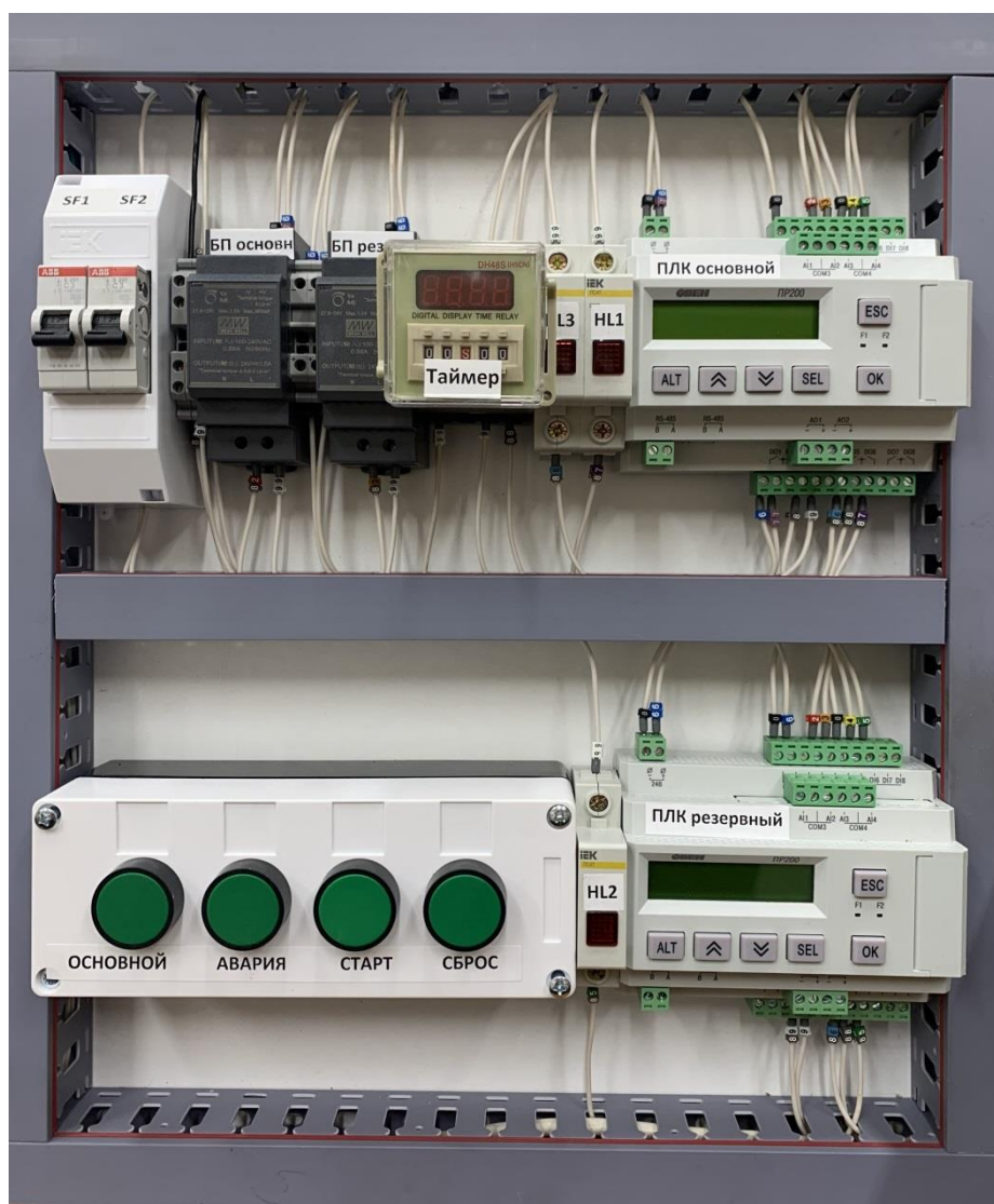
Рисунок 3.1 – Лабораторная установка «Резервирование ПЛК»
