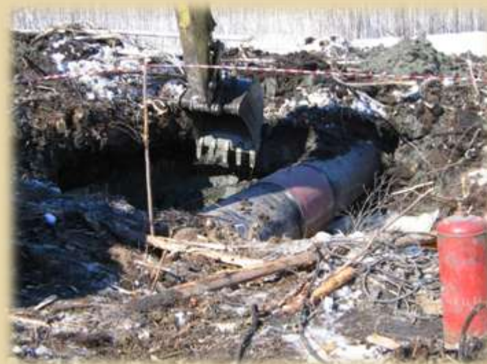
Подземный участок трубопровода
