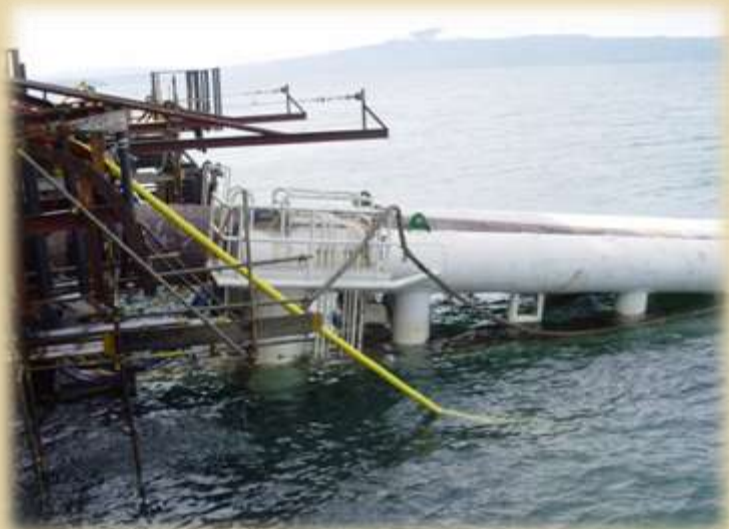
Подводный участок трубопровода
