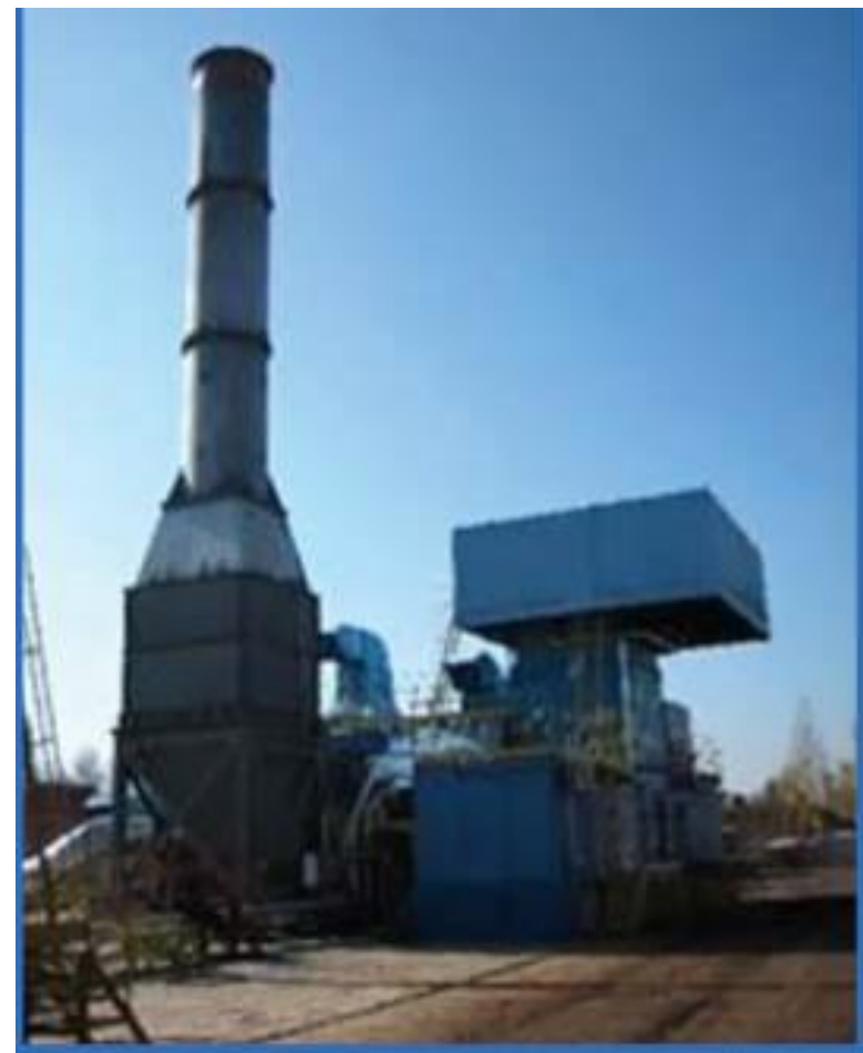
Газоперекачивающий агрегат на компрессорной станции «Пермская»
