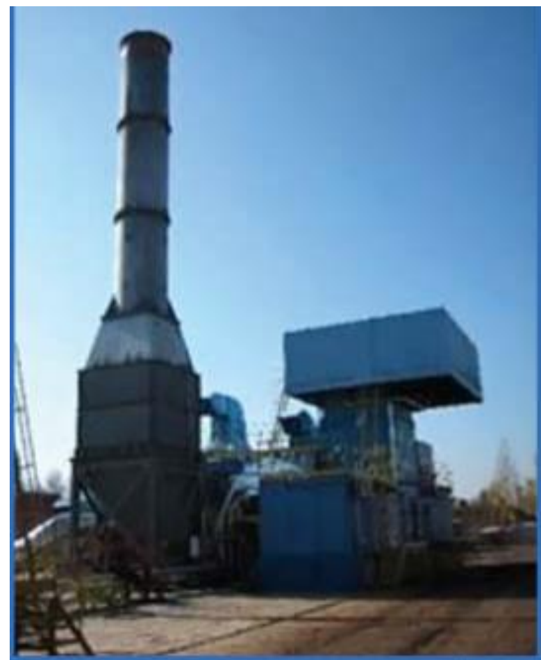
Газоперекачивающий агрегат на компрессорной станции «Пермская»
