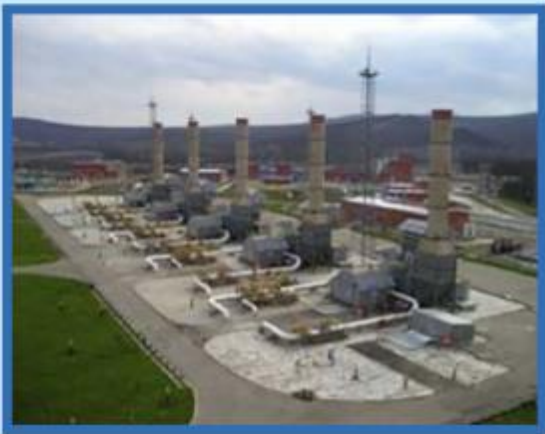
Газоперекачивающий агрегат мощностью 12 МВт на компрессорной станции «Краснодарская»
