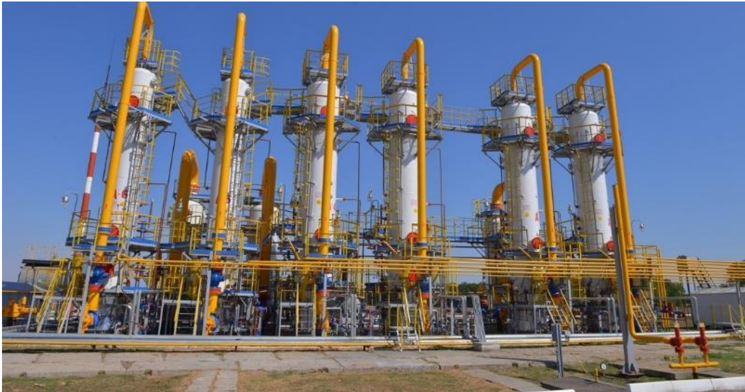
Установка осушки газа
