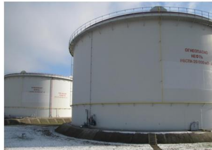
Среднетоннажный изотермический резервуар объемом 20 000 м 3
