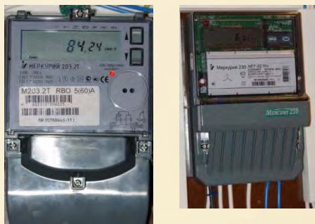
Счетчики электроэнергии «Меркурий» с параметрами качества электроэнергии передача по протоколу RS485
