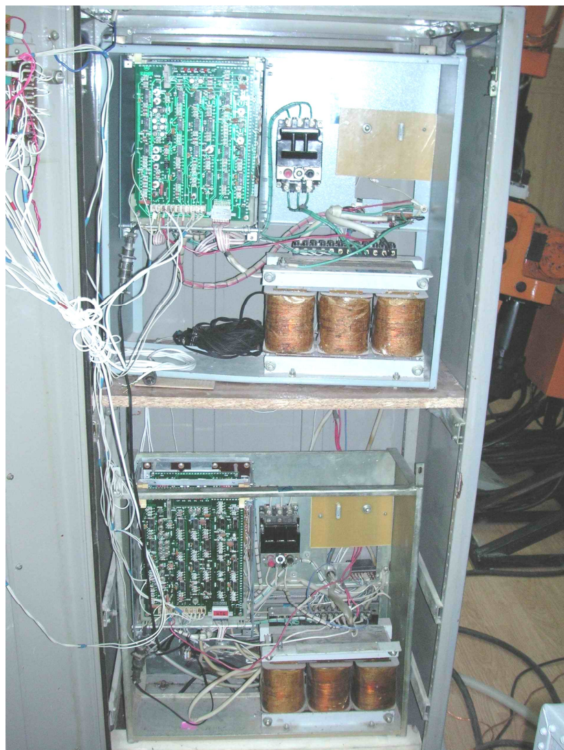
Рис. 2.3. Вид шкафа с электроприводами с открытой дверцей
