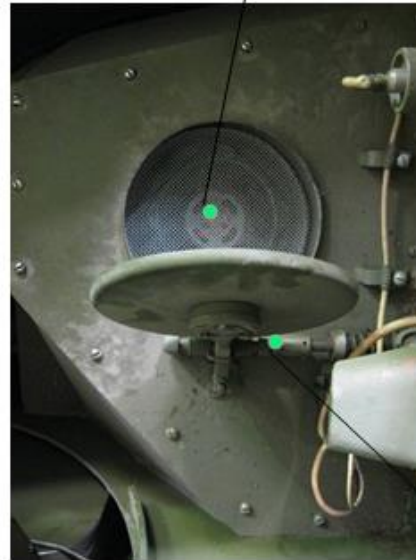
Заслонка воздуховывода шкафа Т-37
