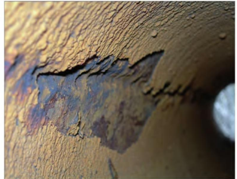
Рис. 2.5. Внутренняя поверхность трубопровода \varnothing 254 \times 10 мм системы ППД полностью покрыта минеральными отложениями. Интенсивная локальная коррозия под отложениями. Месторождение Мишовдаг, Азербайджан, 2006 г.
