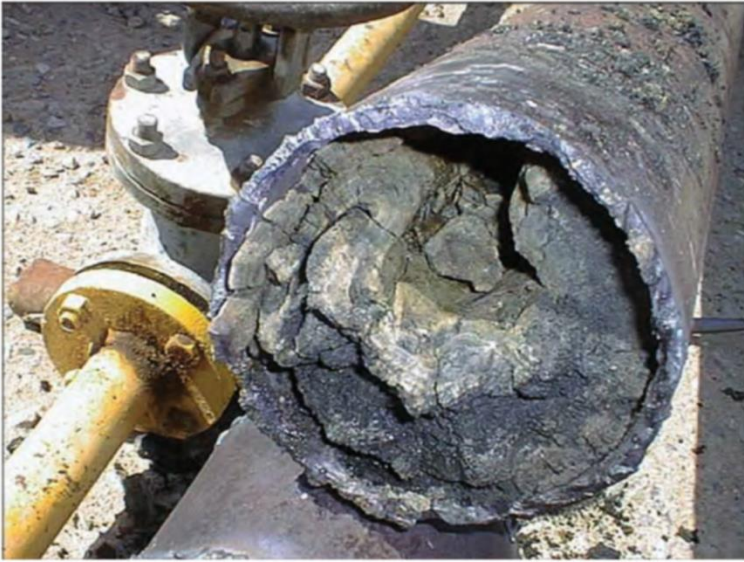
Рис. 2.4. Минеральные отложения в трубопроводе \varnothing 159 \times 8 мм подтоварной воды от сепаратора-подогревателя. Одно из месторождений Кумкольской группы, Казахстан, 2002 г.
