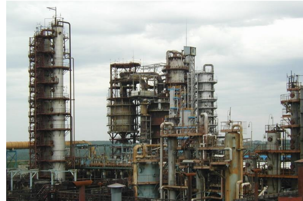
Установка каталитического крекинга 43-107
