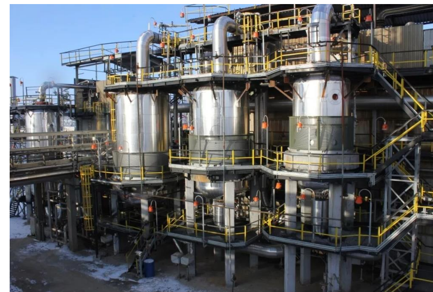
Реакторный блок установки риформинга
