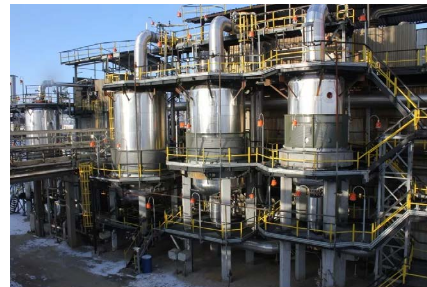
Реакторный блок установки риформинга
