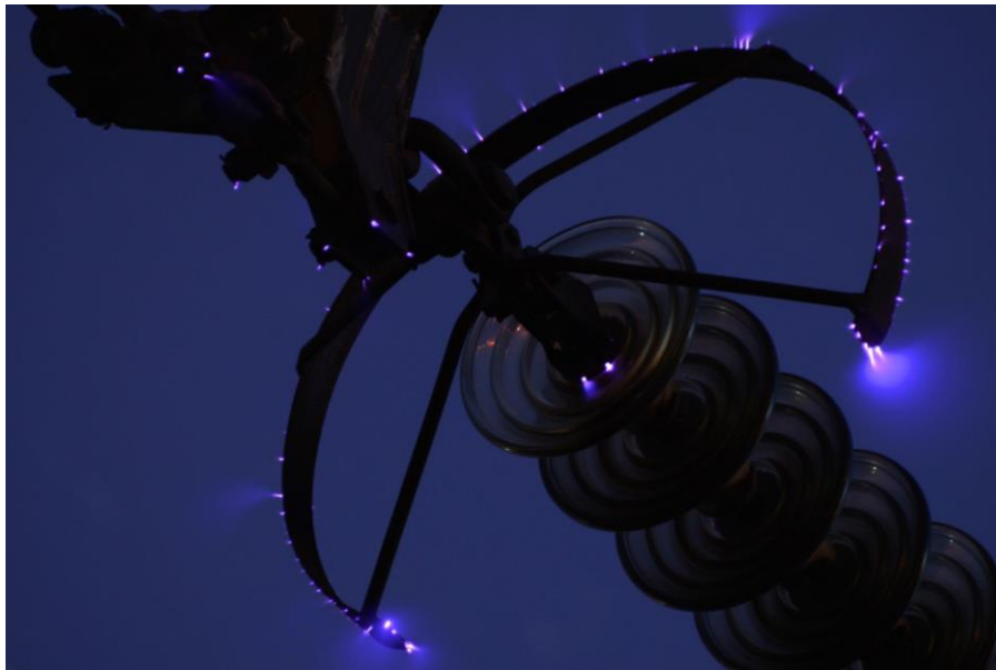
корона на проводах высоковольтной линии
