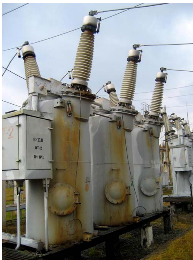
Рис. 2.1. Общий вид баковых масляных выключателей
