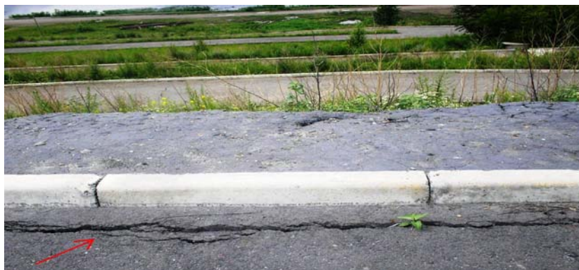
Рис. 55. Трещина в асфальте (Лагерный сад)
