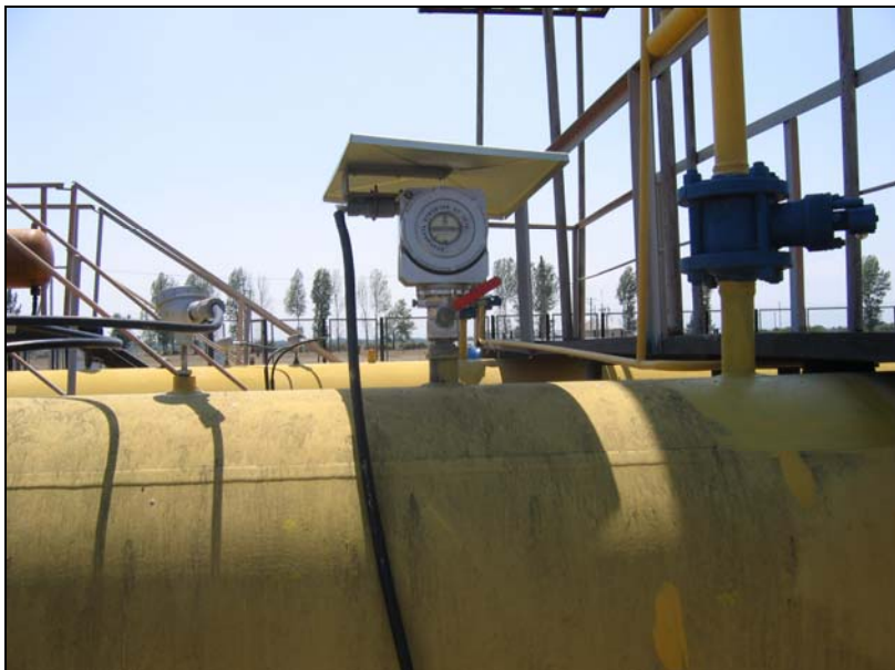
Рис. 4.37. Анализатор точки росы Конг–Прима-2, установленный непосредственно на газопроводе
