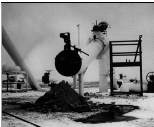
Рис. 4.33. Образование гидратов в газопроводе
