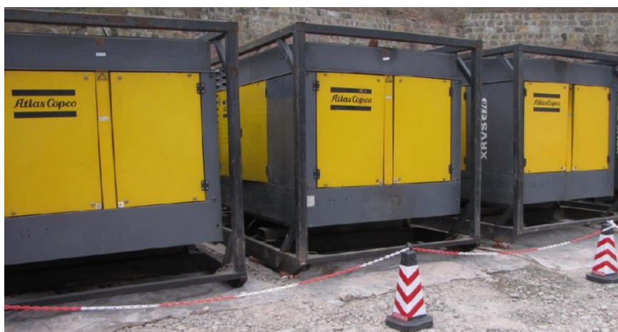
Рисунок 19 – Компрессоры SULLAIR Combo1150XHH/1350XHDL на Куюмбинском месторождении при проведении производственного эксперимента
